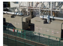
コージェネレーションシステム
