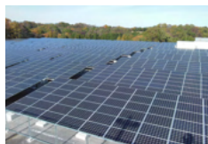
エルナー白河太陽光発電所
