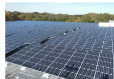
エルナー白河太陽光発電所
