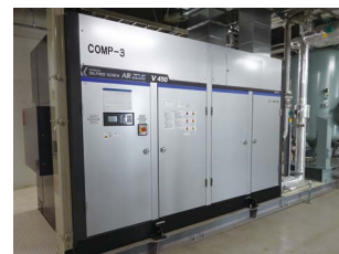
圧縮エアを供給するコンプレッサー
