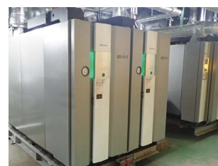
空調用のボイラー
